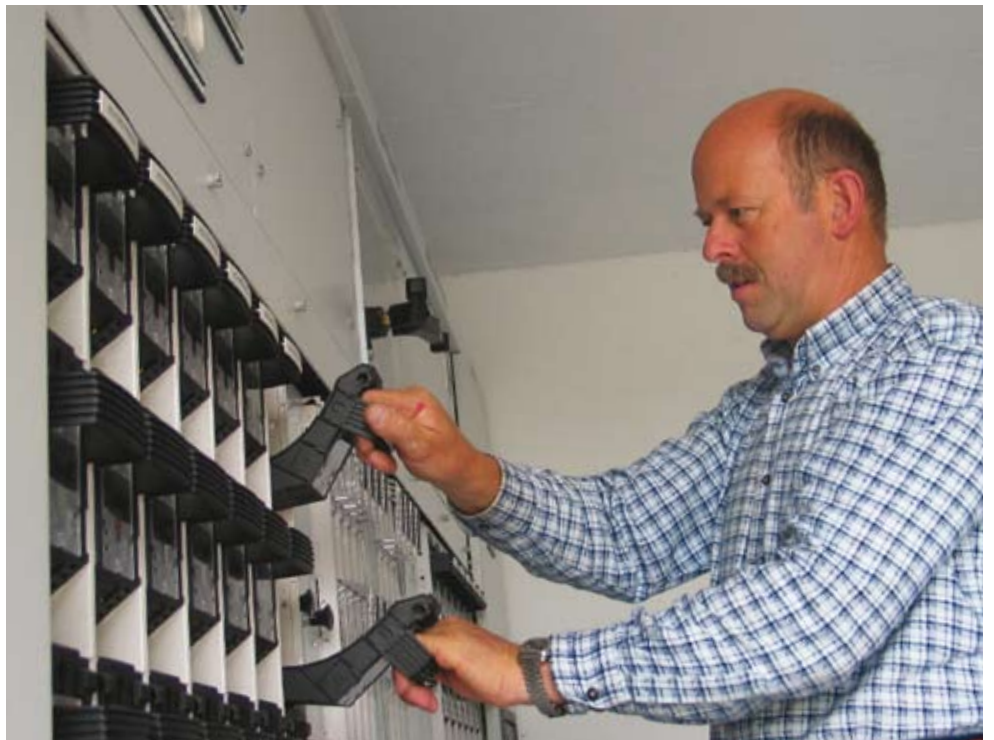
Manfred Wälchli an der Niederspannungsschaltanlage
