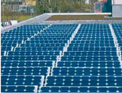
Solarstrom auf dem Dach des Betriebsgebäudes
