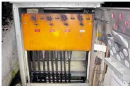
TS Industriestrasse 8 nach dem Brand
