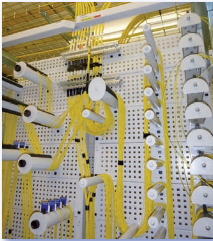
Glasfasern in der Zentrale
