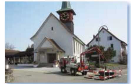
Mittelspannungskabelzug zwischen zwei Transformatorenstationen
