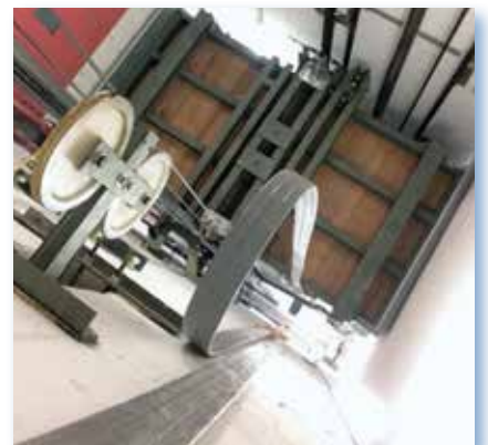
Warenlift im Feuerwehrgebäude
