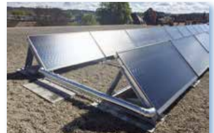
Solaranlage Sporthalle Hüenerweid
