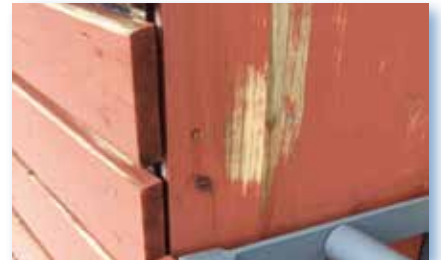
Defekte Fassade Bertea Dorftreff
